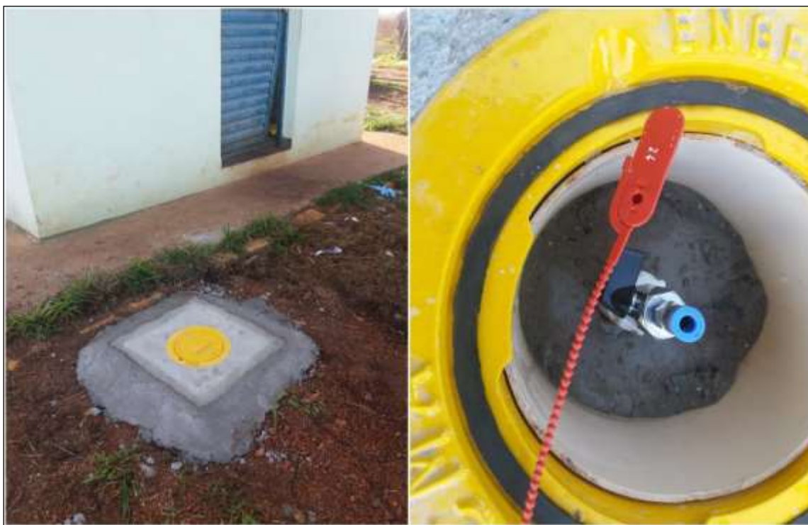
Figura 7.3: Poços de Monitoramento dos gases
